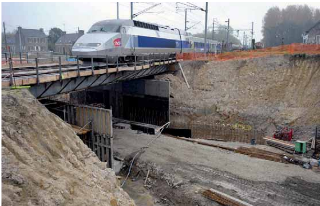
▲ Le projet Bretagne à grande vitesse comprend la réalisation de la LGV, mais aussi l'amélioration de la liaison entre Rennes et Brest, notamment à travers la suppression de passages à niveaux, comme ici à Plounérin en 2009.
