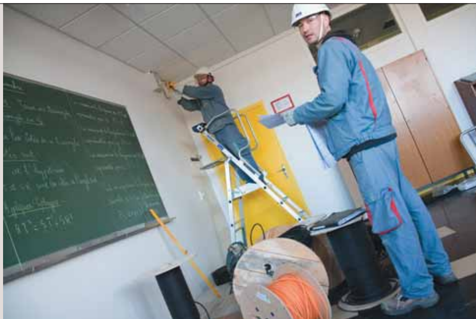
Au collège Léonard-de-Vinci à Saint-Brieuc, les travaux de mise aux normes électriques ont été l'occasion de réfléchir à des dispositifs permettant de réduire la consommation d'électricité.
