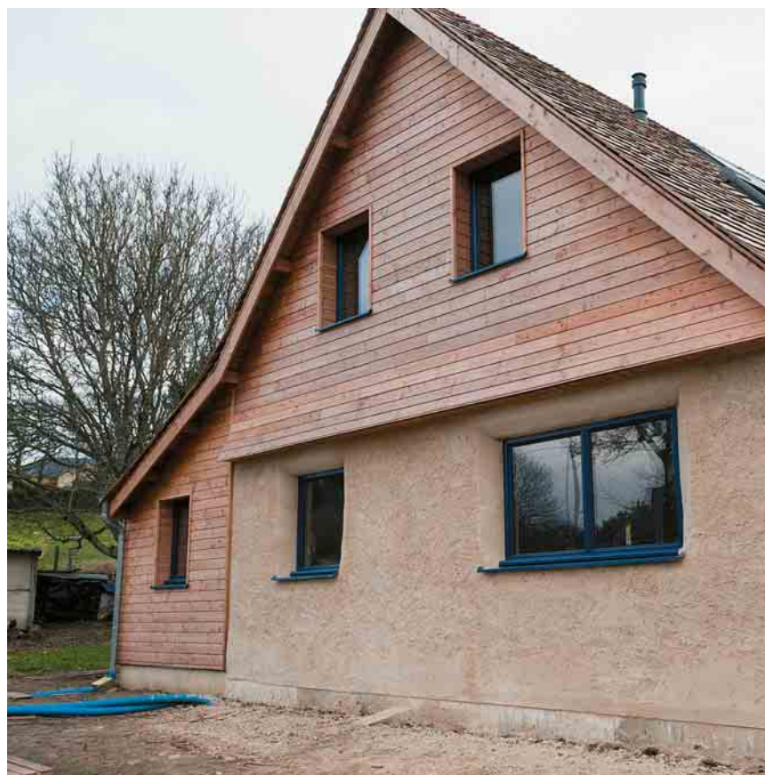
La maison que construit Robin Gobet à Binic. Une fois appliqués les enduits, on ne voit plus la paille.
