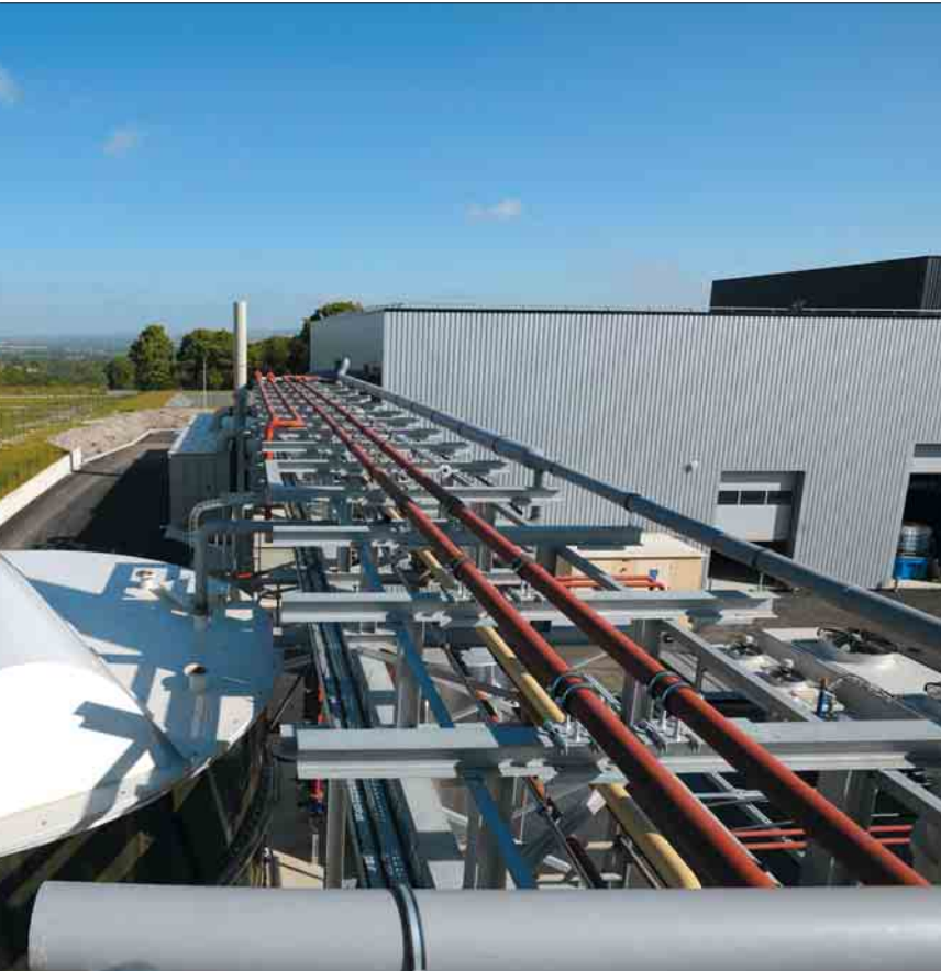
La toute nouvelle usine de méthanisation Géotexia transformera en énergie 35 000 t de lisier et 40 000 t de déchets de l'industrie agroalimentaire.
